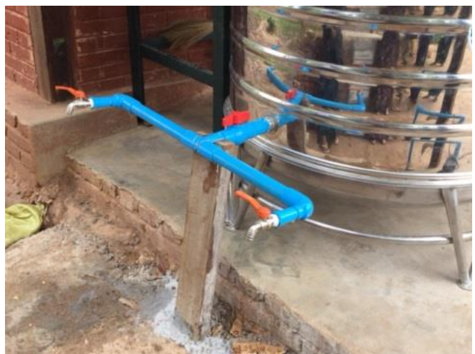
Edelstahltank zur Wasserversorgung
